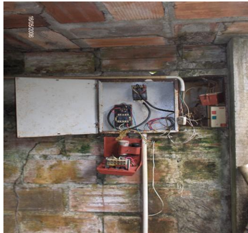
Fragilidad y deterioro de obras Estación de bombeo Vijagual: elementos sueltos, caja desajustada y dispositivos de protección inadecuados
