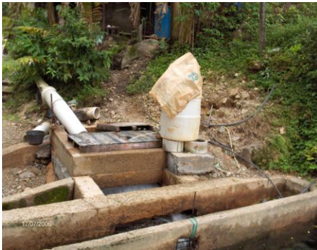
Dosificador rudimentario de cloro PTAP
