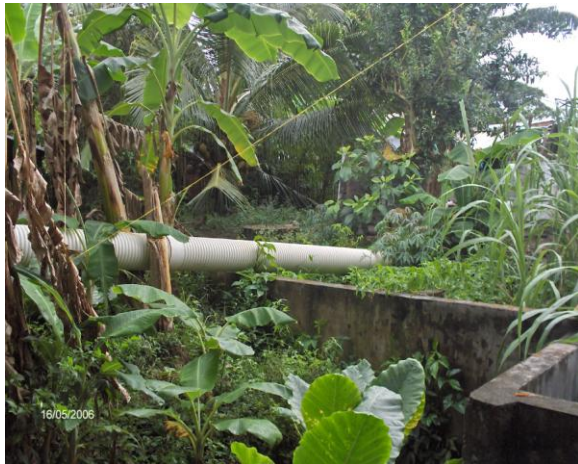
Bypass de desagüe a río que fue instalado debido a que la PTAR colapsó
