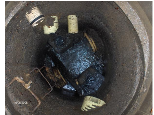
Inadecuado empalme de tuberías en pozo de alcantarillado y falta de cámaras de caída
