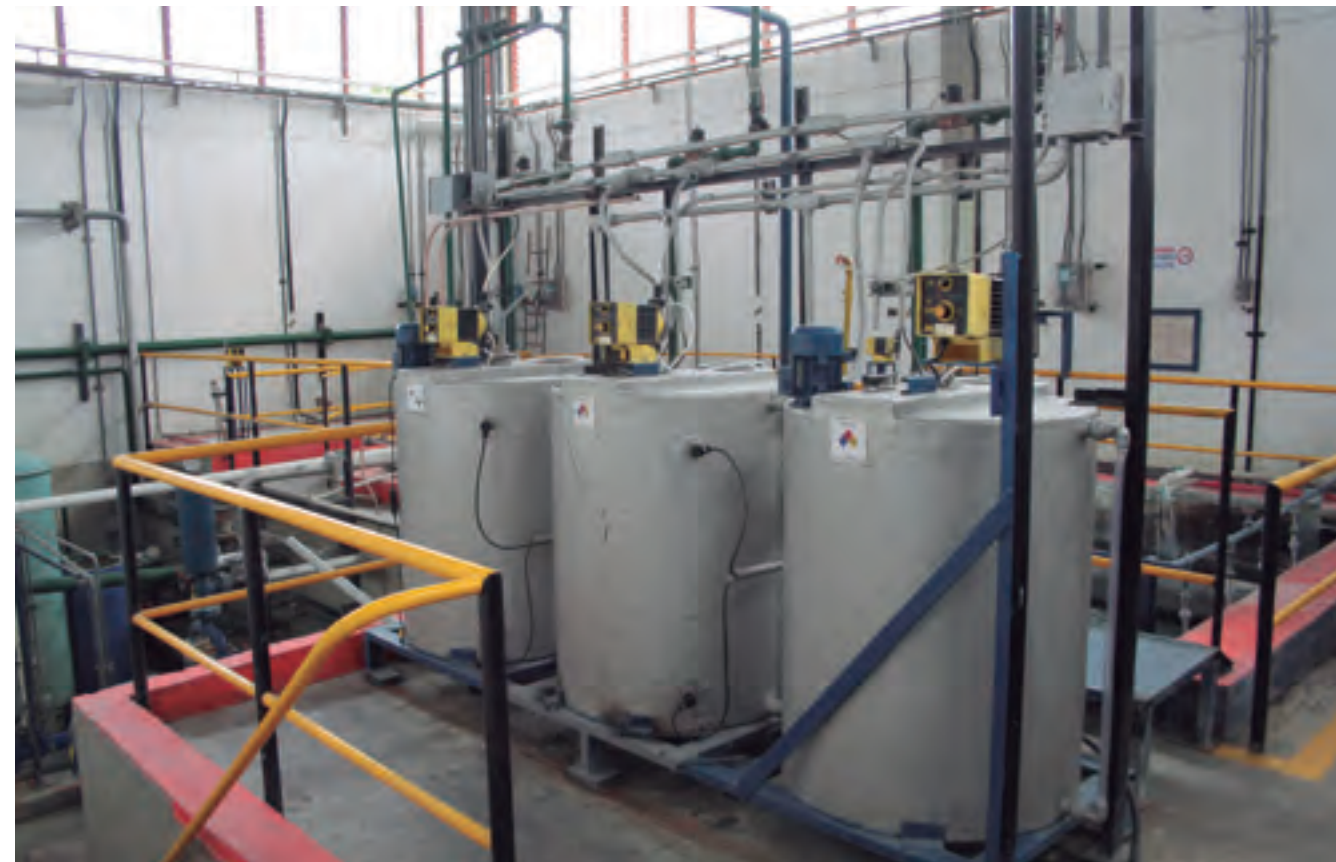
Planta de tratamiento de aguas residuales en la Fábrica de Moneda en Ibagué.
