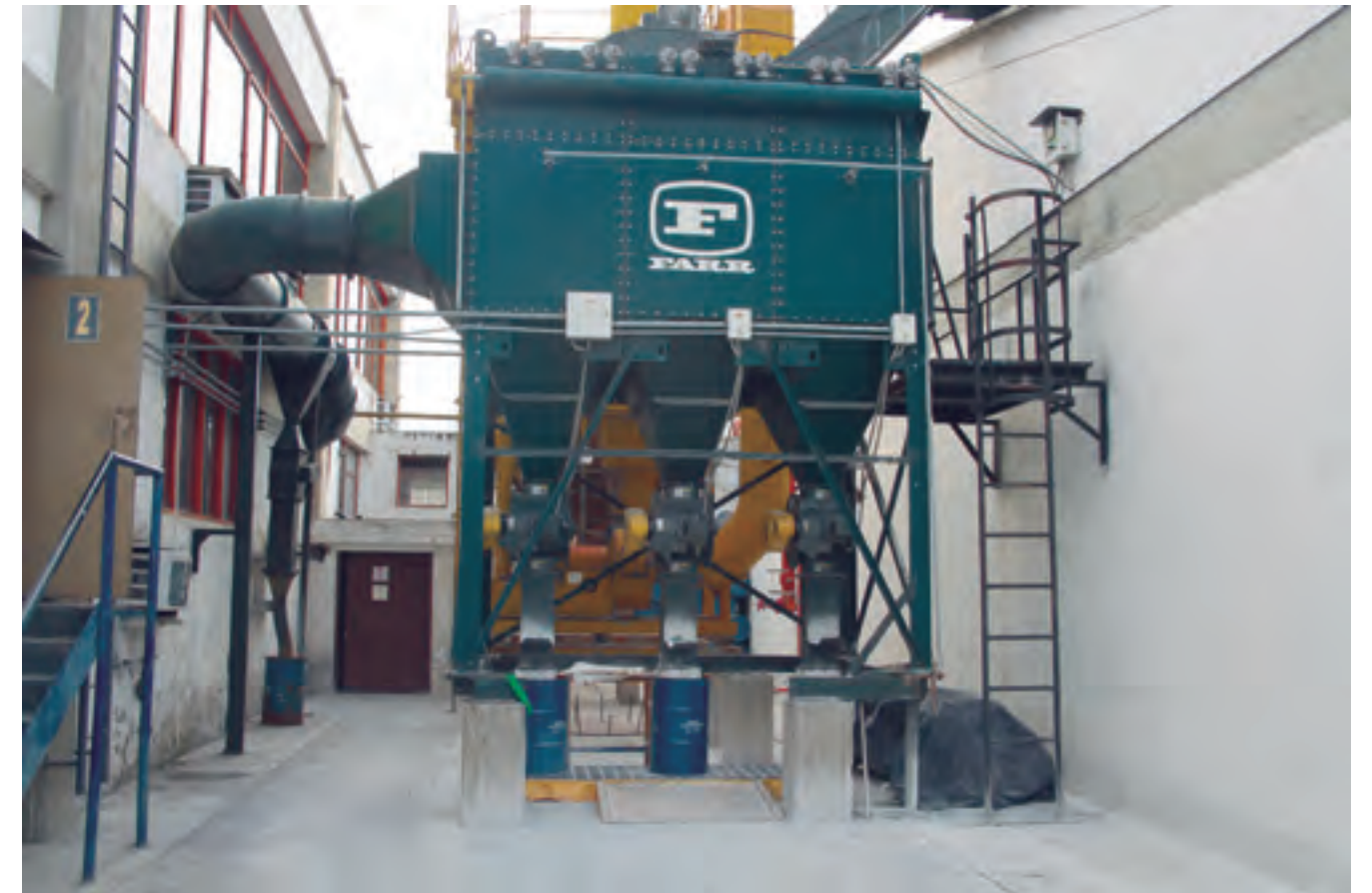
Filtro purificador de aire ubicado en la Fábrica de Moneda en Ibagué.
